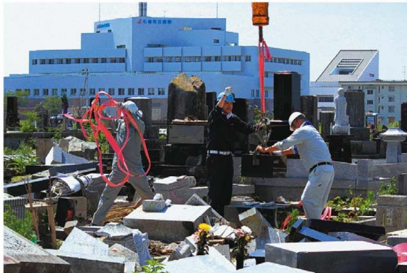
東日本大震災の津波にのまれた宮城県石巻市の墓地(日本石材産業協会提供)
